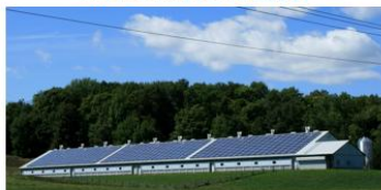
Photovoltaïque en toiture
